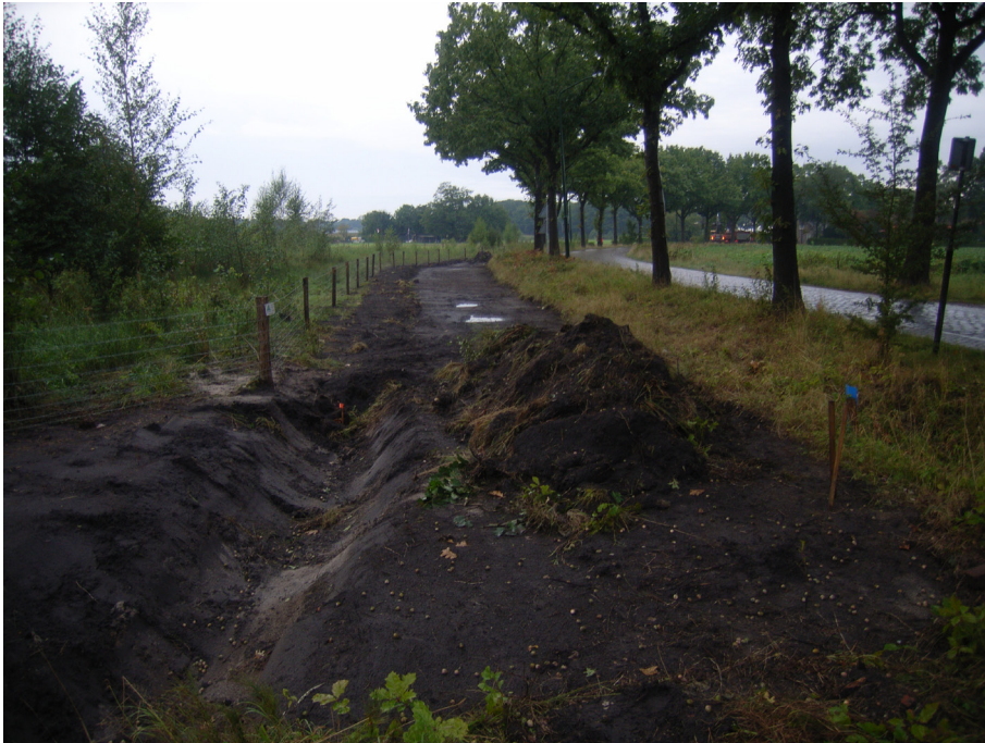
Afb. 4.1 Foto van het onderzoeksgebied genomen ter hoogte van de kruising van het Vooreind en de Kruisdijk richting het noorden.
